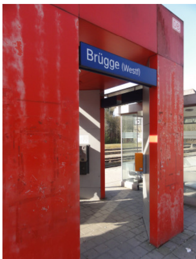
Der sehr unansehnliche DB Pluspunkt in Brügge wurde neu gestrichen (hier: alter Zustand)
